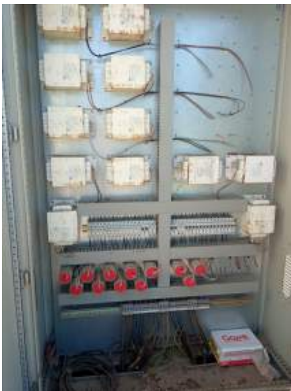
Subcuadro en base Torre
