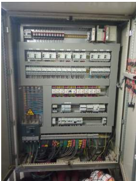
Cuadro principal, parte interior
